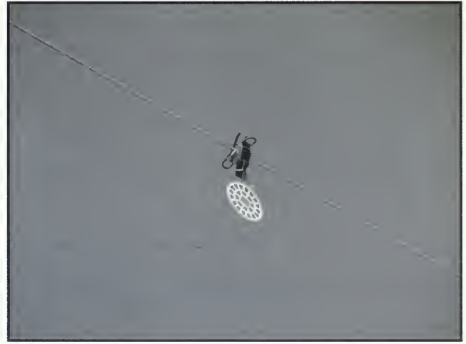
Figure 4: Un dispositif "Bird Flapper" qui est attaché au conducteur aérien et bouge avec le vent.
