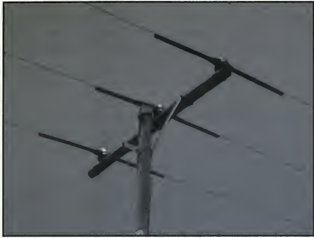
Figure 3: "Protecteurs de rapaces " sont utilisés pour isoler les conducteurs à un mètre de chaque côté de la traverse sur les structures du poteau T en bois
