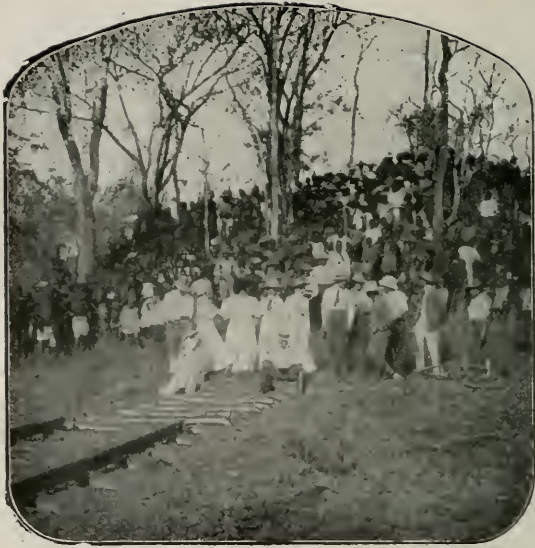
De voltooiing van den spoorweg van Elizabethstad naar de mijn « De Kongoster ».
